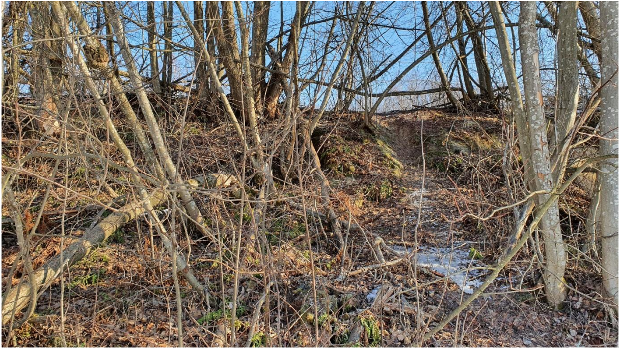
Figur 4. Exempel på erosion i slänten p.g.a. ytavrinning.
