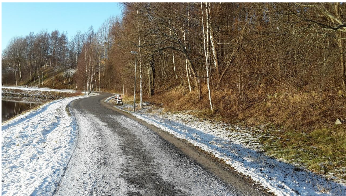
Figur 22. Stödfyllning och erosionsskydd i släntröt vid Strandpromenaden längs Umeälven.
