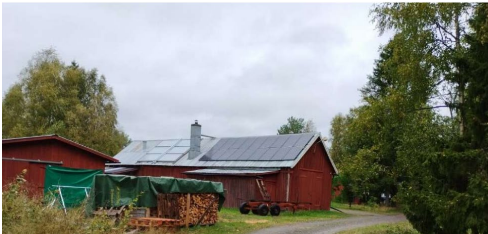
Foto på byggnaden på fastigheten Ström 5:7 med solceller mot gatan
