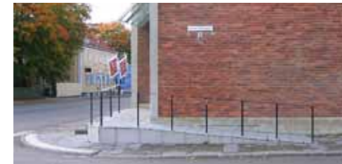
Ramp i kv Höder som skadats av snöröjning.
