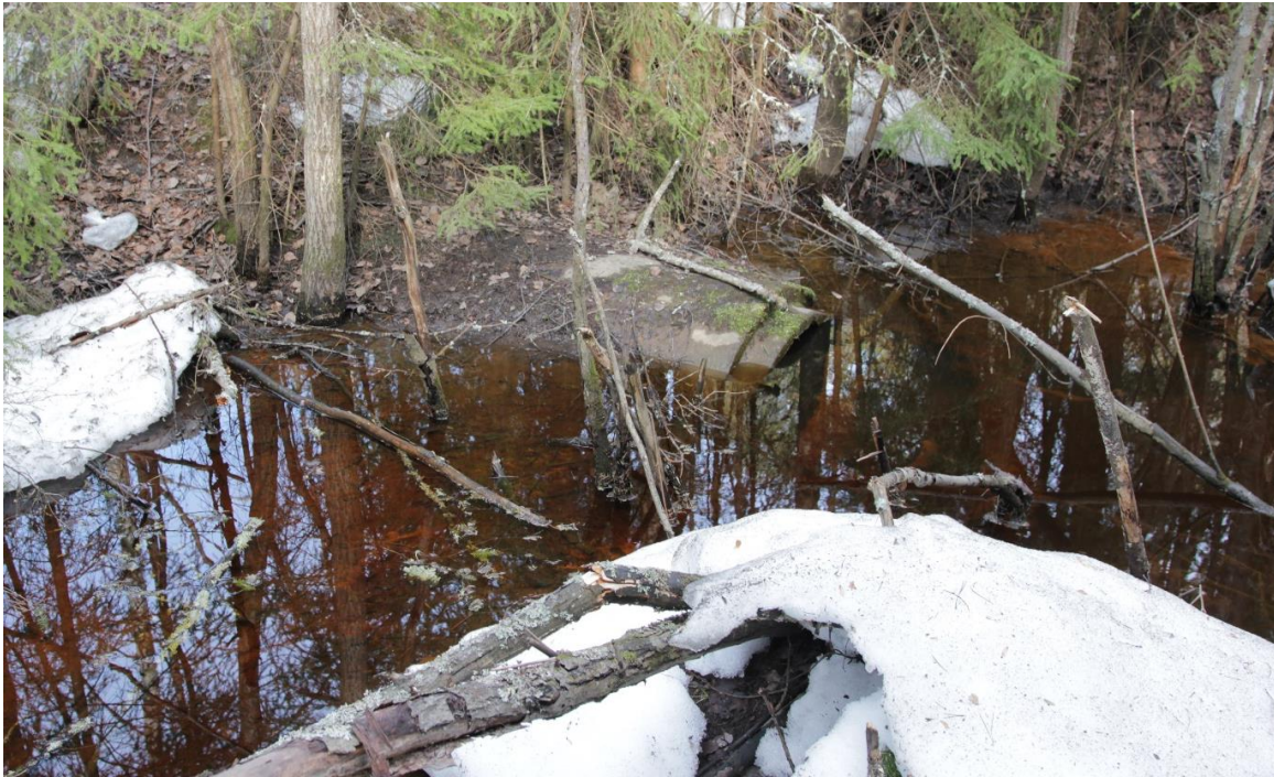
Figur 15. Punkt 2. Utlopp dagvattenledning 1000 mm betong vid Kolbäcksvägen. Stillastående vatten. Mottagande dike har högre dikesbotten längre nedströms vilket kan vara en av flera orsaker till dämt utlopp.
