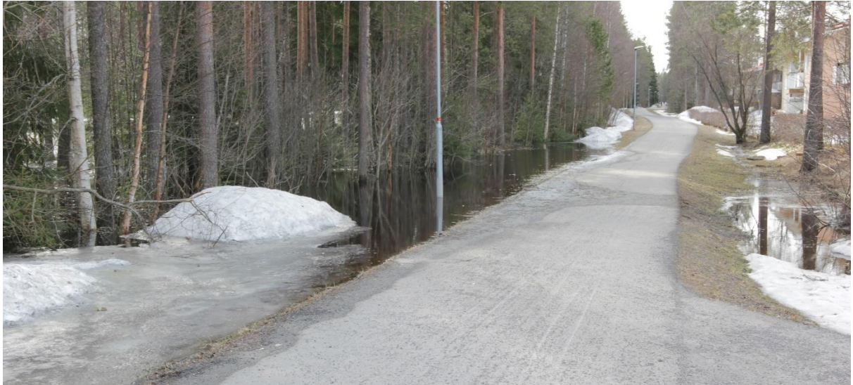
Figur 16. Punkt 3. Stående vatten mellan gångbana och Kolbäcksvägen vid korsningen Mjölkvägen/Kolbäcksvägen.
