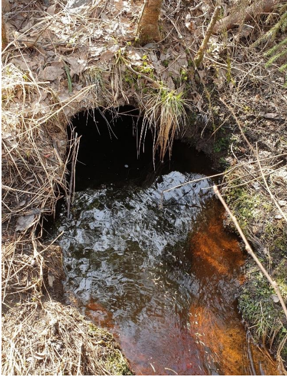
Figur 14. Punkt 1. Trummöga 800 betong, utlopp vid Krossvägen. Strömmande vatten. Trumma fylld till ca 80%.
