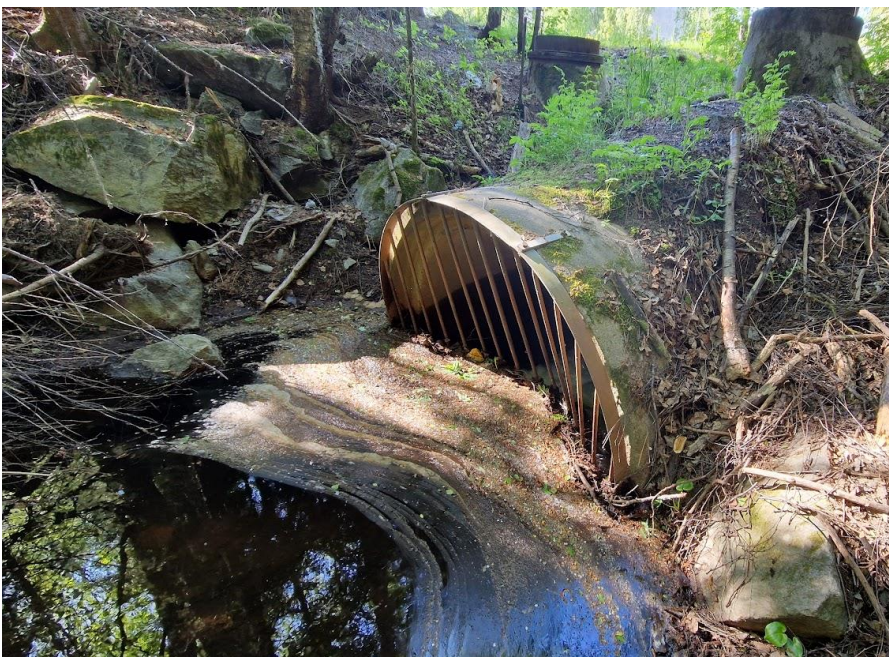
Figur 10. Kulvertintagets galler har böjts inåt och på ytan står vattnet still. Bakom gallret skymtar det forsande vattnet på en lägre nivå. Bild: Sweco.
