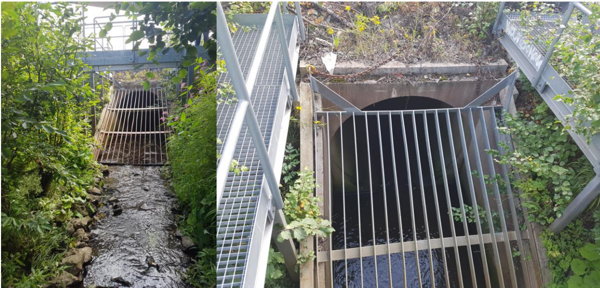
Figur 11. Exempel på ett sluttande intagsgaller, förberett för att kunna lyftas upp vid rensning. Bilder: Sweco.
