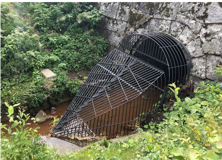
Figur 12: Exempel på ett stort intagsgaller där tanken troligen var att styra skräp åt sidorna. Gallret har dock många utstickande detaljer där skräp kan fastna. Bild: Sweco.
