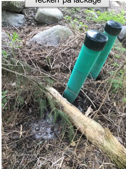
Tecken på läckage
