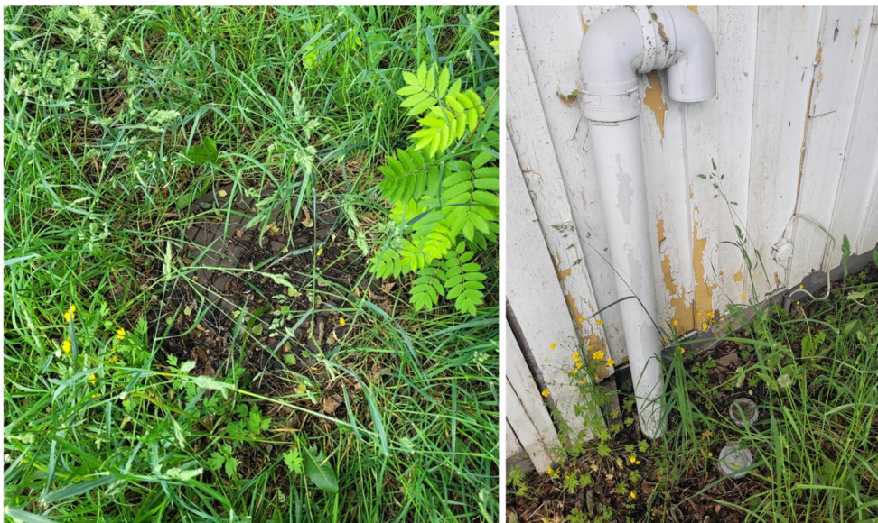
Figur 4. Oljeavskiljare samt avlufts- och påfyllningsrör vid punkt 25T08.
